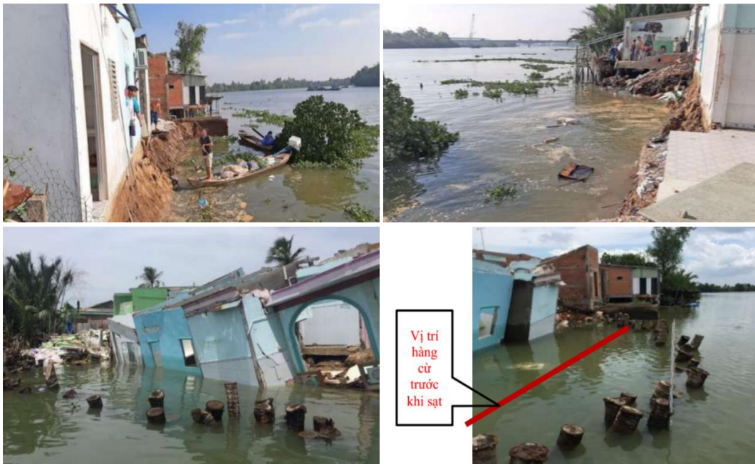
Hình 11. Sạt lở bờ sông khu vực Rạch Chanh, xã Lợi Bình Nhơn [4].
